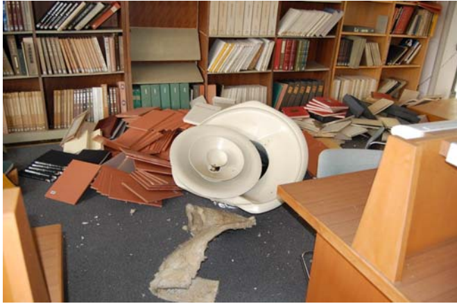
体芸図書館 3階閲覧席です。天井から空調通風孔が落下してきました。(3月14日撮影)
