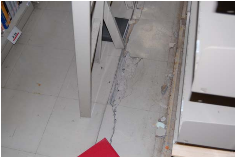
中央図書館A書庫の床に発生した亀裂です。(3月17日撮影)
