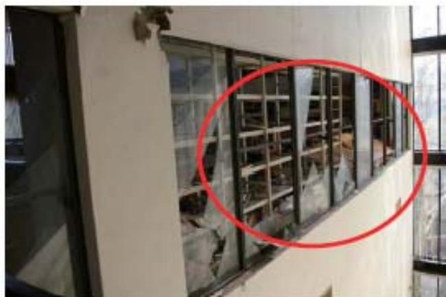
体芸図書館3階大閲覧室・吹き抜け側のガラスが破損。
