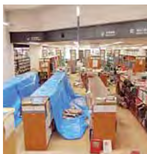
天井部分の落下 (医学図書館)
